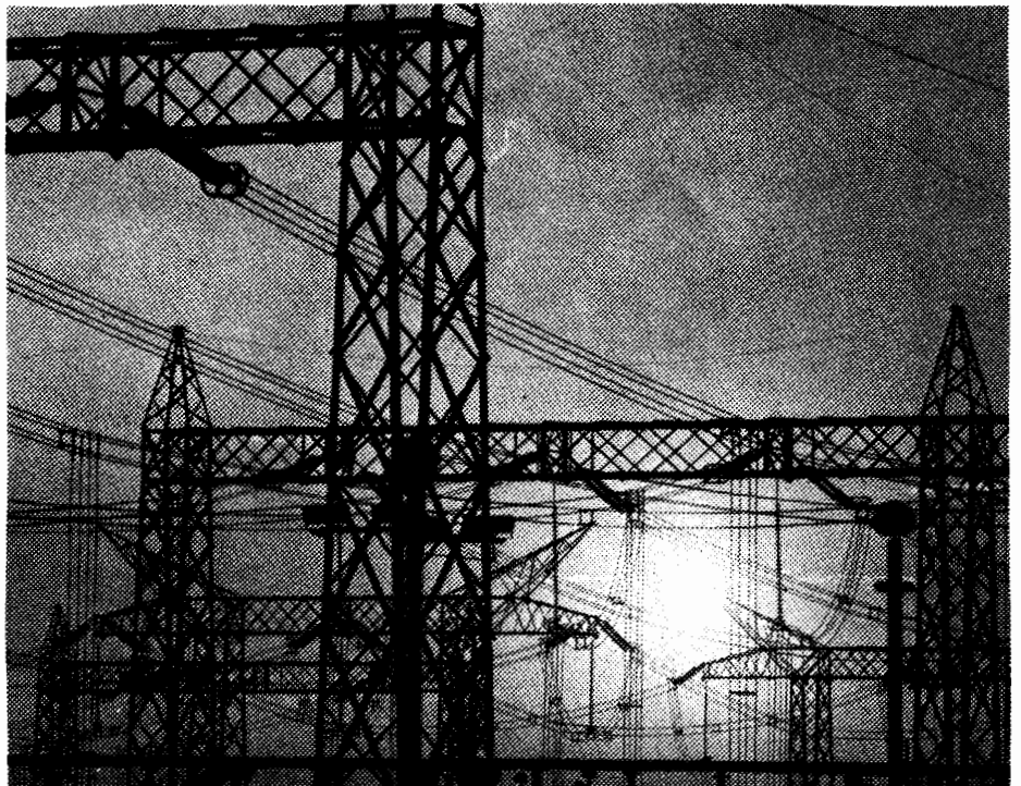
Subestação de 750 kV - Foz do Iguaçu
