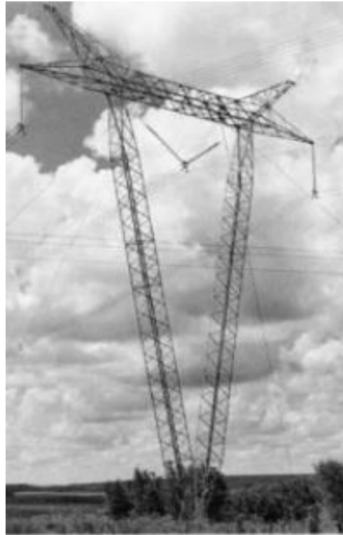
Estaiada 440 kV/46 m
