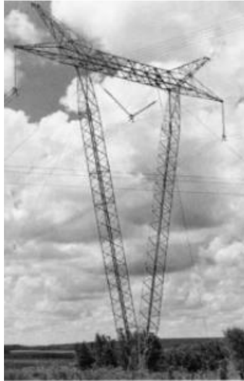
Estaiada 440 kV/46 m
