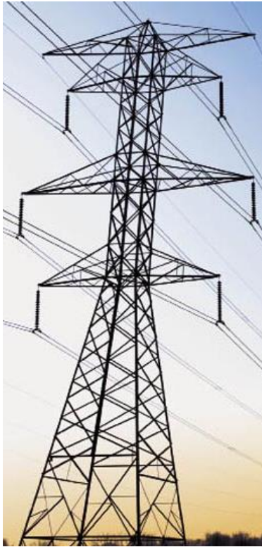
Autoportante circuito duplo 400 kV/45 m
