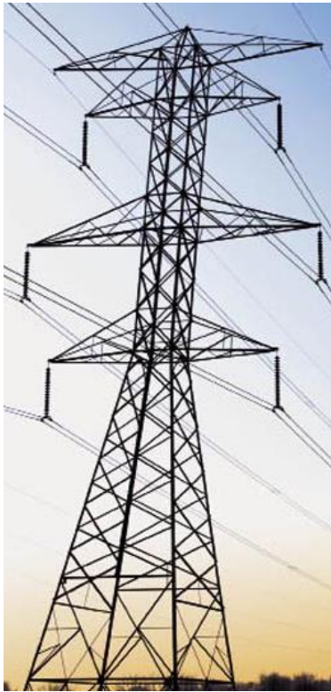
Autoportante circuito duplo 400 kV/45 m
