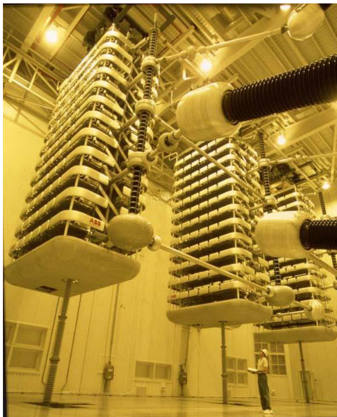
Válvula de tiristores em sistema HVDC http://cigre.org.au/events/Web/images/HVDC_Pole_2_Valve_Hall.jpg
